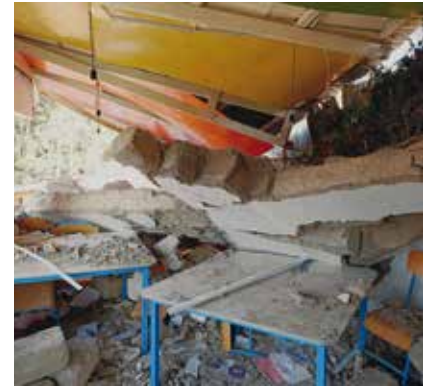
Oktober 2023: eines der vollständig zerstörten Klassenzimmer. (Bild zvg)
