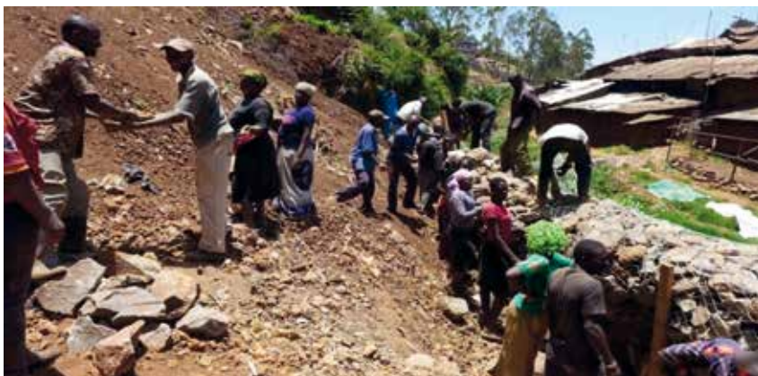
Mit vereinten Kräften und tatkräftiger Unterstützung der Eltern wird das neue Schulgelände begradigt.
